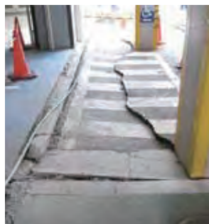
戸塚区役所の被害調査 (H23.3.12)
