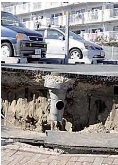
マンションにおける液状化被害調査 (H23・3・12)
